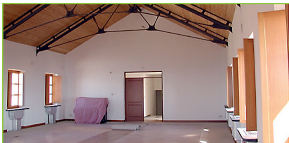
Canali di mandata e ripresa aria per la climatizzazione del locale anch'essi dissimulati nelle boiserie sotto finestra.
