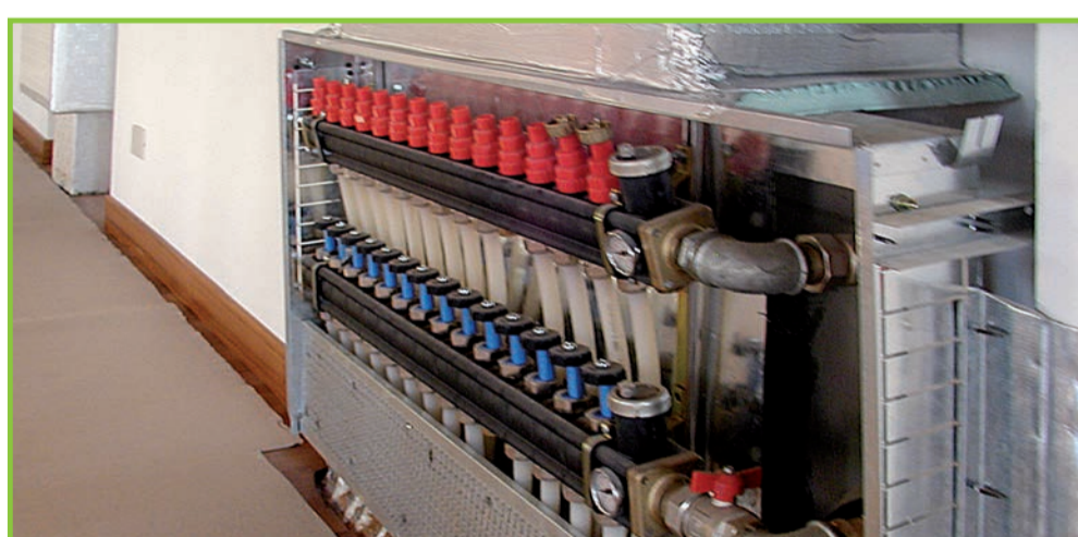
Collettore dell'impianto a pavimento dissimulato nelle boiserie sotto finestra
