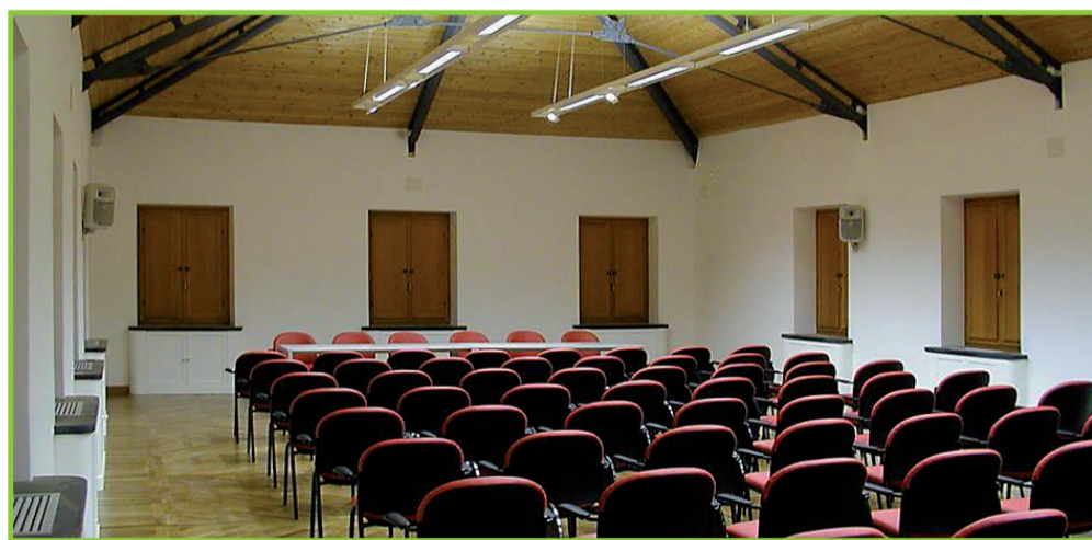
Boiserie della sala sotto finestra contenenti elementi tecnici dell'impianto di climatizzazione e librerie chiuse da ante.
