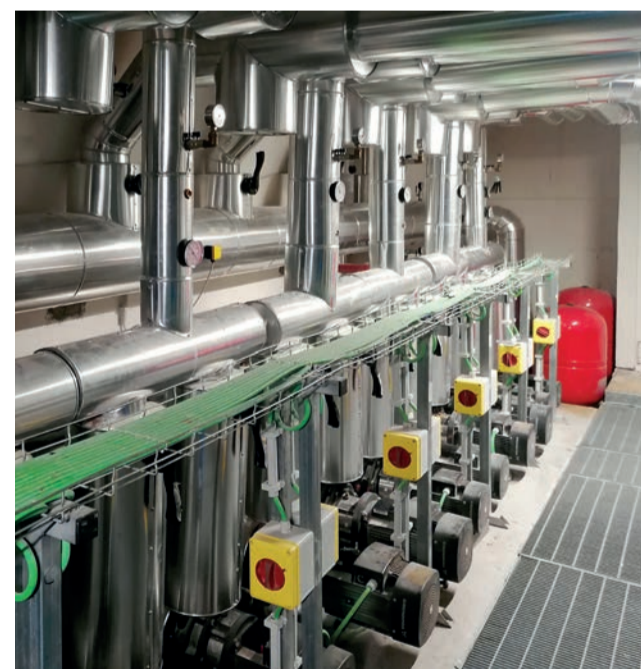
Particolare della sottostazione con i gruppi di rilancio.
