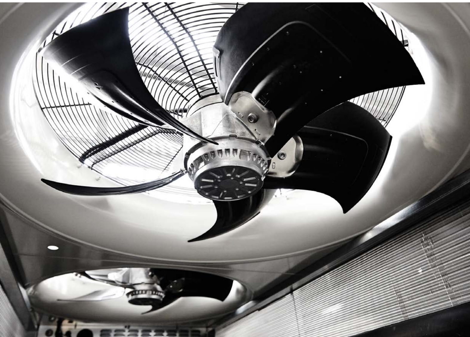
Ventilateurs de dernière génération sur un refroidisseur Aermec
