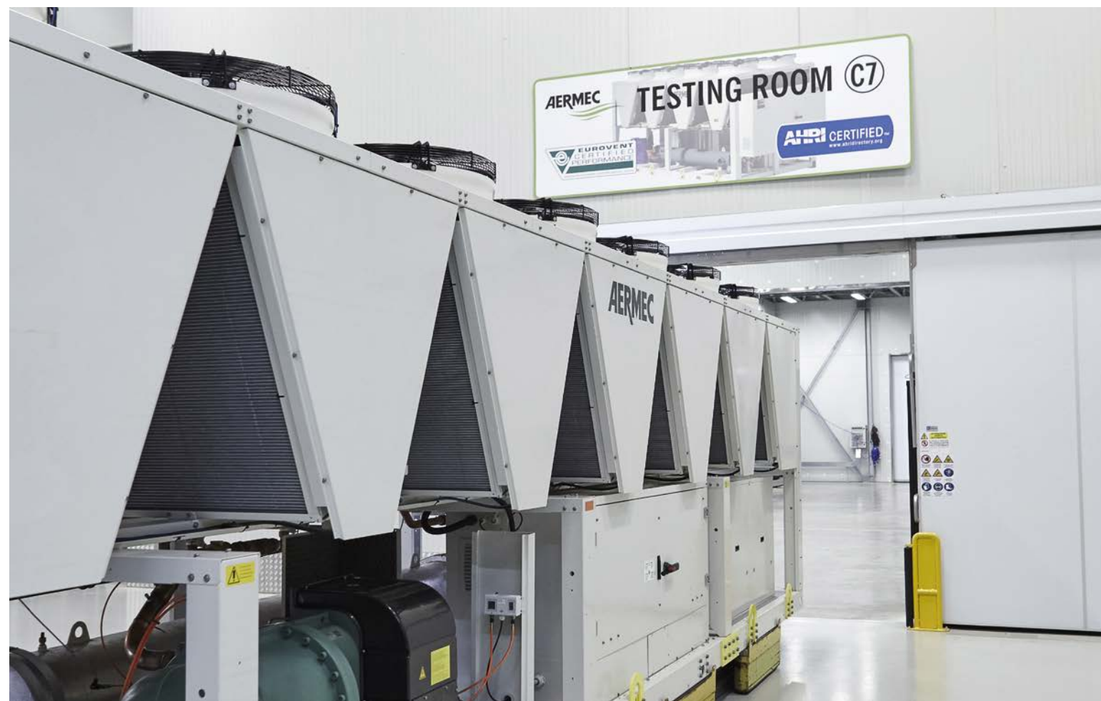
Chambre calorimétrique utilisée également pour effectuer des essais de certification Eurovent
